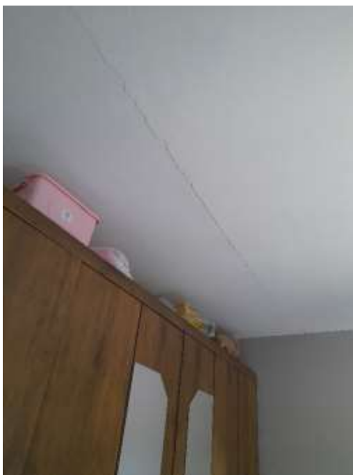
Laje com trinca
