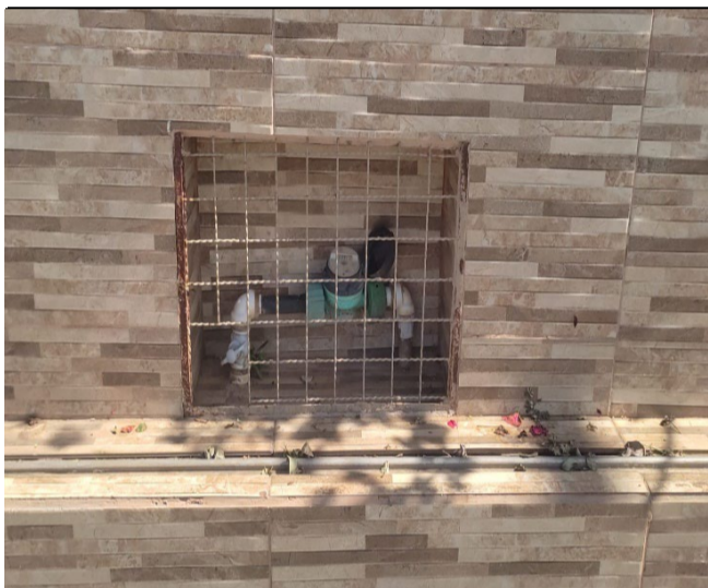
15 - Medidor de água.
