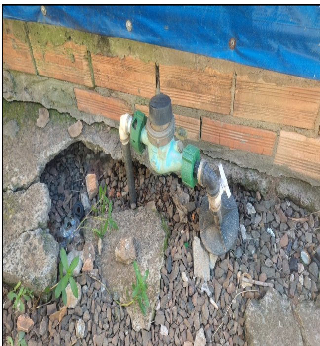
11 - Medidor de água.
