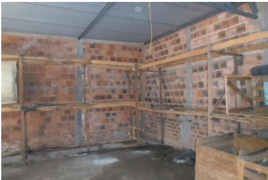
FOTO 16 – Anexo fotográfico destinado a mostrar uma vista geral do barracão inacabado existente nos fundos do imóvel, podendo-se observar a cobertura com estrutura e telhas metálicas, o piso cimentado e as paredes sem chapisco e reboco.
