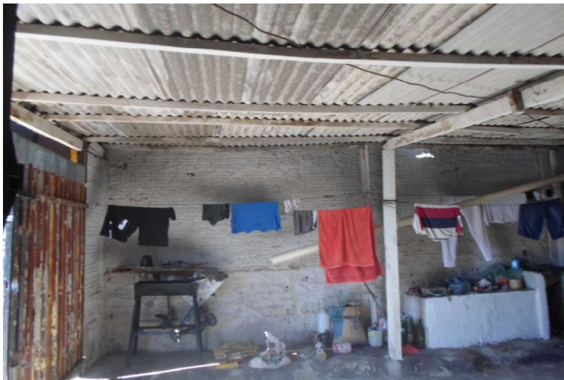
FOTOS 6, 7 e 8 – Anexo fotográfico destinado a mostrar a estrutura da cobertura em madeira e as telhas de fibrocimento do barracão do lado esquerdo de quem da rua olha para o imóvel, sendo que ambas encontram-se em péssimo estado de conservação.
