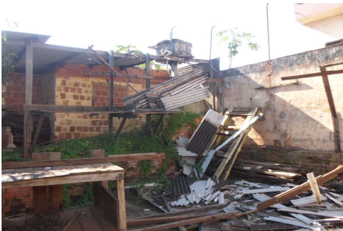
FOTOS 12 e 13 – Anexo fotográfico destinado a mostrar o espaço entre o barracão da frente e o outro barracão inacabado existente nos fundos. Nas fotos pode-se observar bastante entulho no local.
