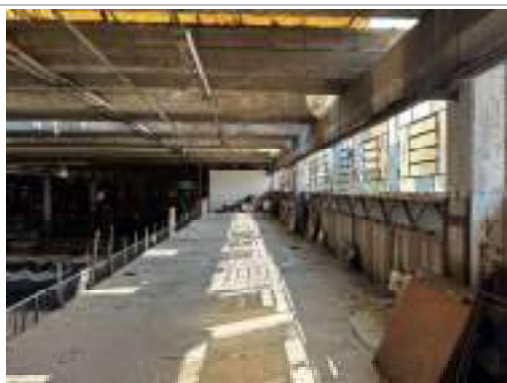
Vista Geral – Galpão / Produção Área incendiada
