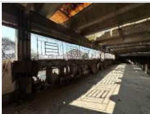
Vista Geral – Galpão / Produção Área incendiada
