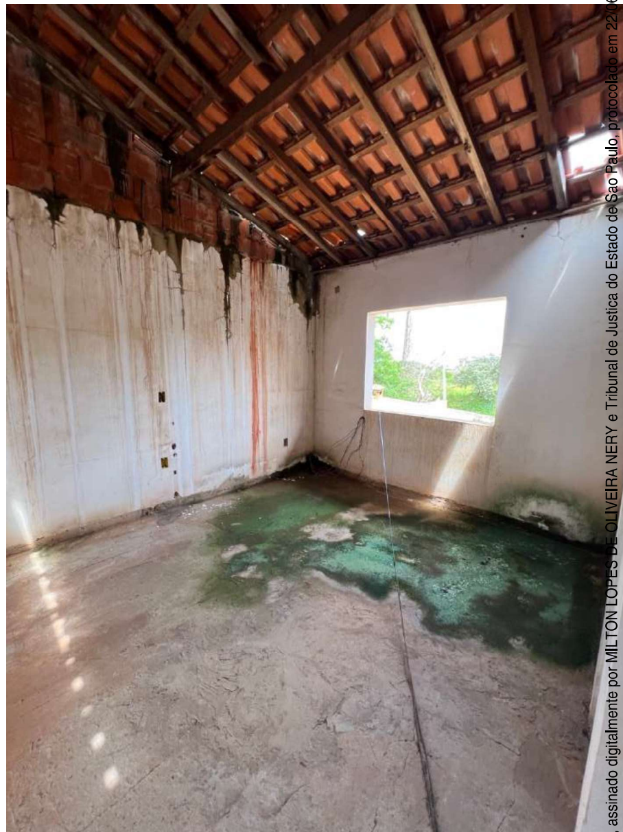
VISTA DO DORMITÓRIO DO 1º PAVIMENTO, PODENDO OBSERVAR INFILTRAÇÕES.
