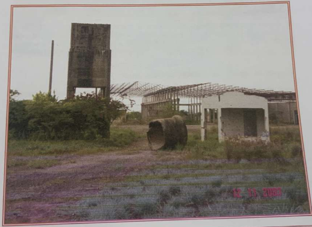
FOTO nº09: Vista parcial do imóvel a ser avaliado neste trabalho, onde podemos ver as os barracões e demais instalações da Empresa ora Requerente, nas margens da Rodovia Fausto Santomauro, a SP-127, no Km 11 + 200 metros. (Foto 12/11/03 - data da vistoria). Nesta fotografia podemos observar o que restou da portaria, do barracão aos fundos e a caixa d'água.
