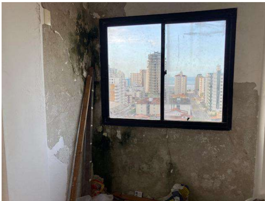
Foto 11 | Pormenor da janela de correr em alumínio da jantar. Presença de umidade junto do caixilho provocou o desprendimento da massa corrida e pintura.
