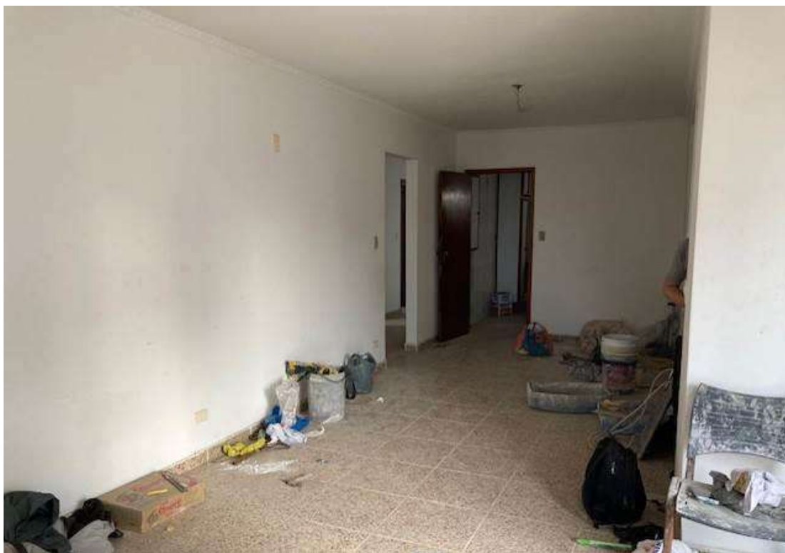
Foto 9 | Piso de cerâmica, paredes com pintura látex PVA e forro de gesso da sala de jantar.
