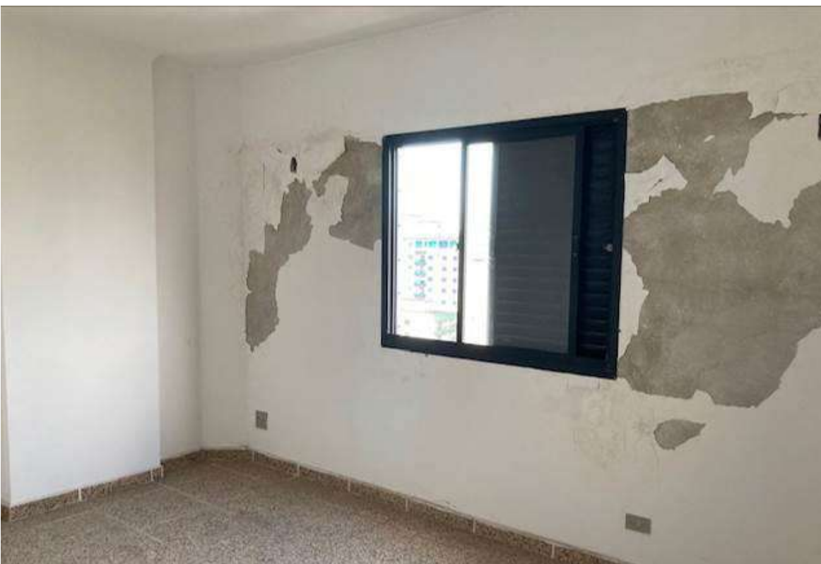
Foto 16 | Dormitório com piso em cerâmica, paredes com tinta látex PVA apresentando desagregação na argamassa, janela de correr com veneziana em alumínio e forro de gesso.
