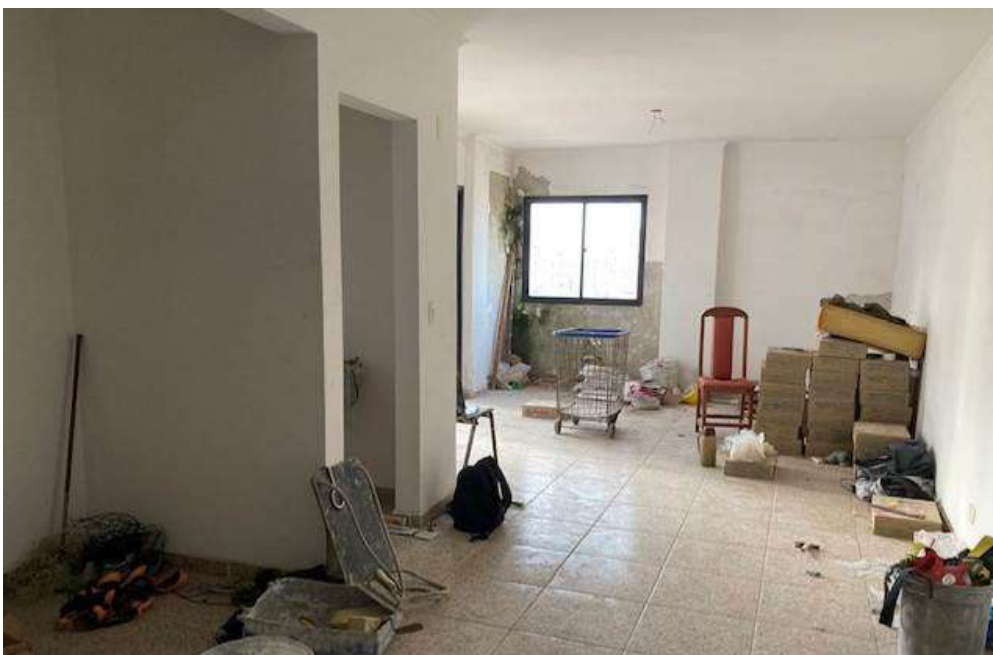
Foto 10 | Piso de cerâmica, paredes com pintura látex PVA e forro de gesso da sala de estar.
