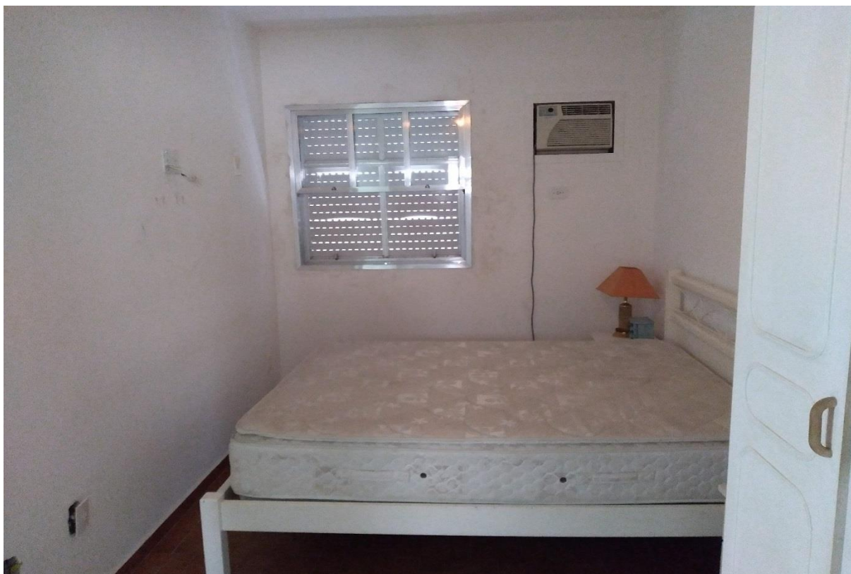
FOTO 19 – Vista parcial de outro dormitório com infiltrações nas paredes junto a esquadria da janela.
