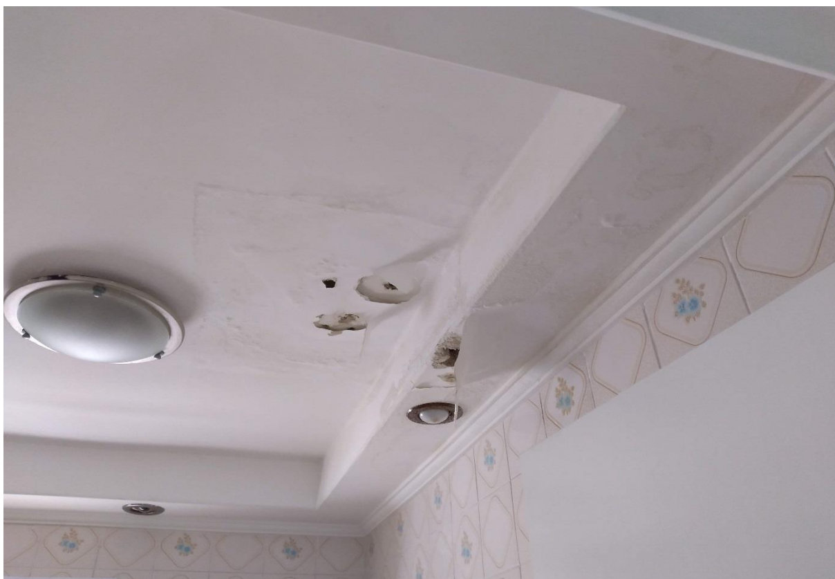
FOTO 18 – Vista parcial do teto do banheiro social com danos por infiltrações.
