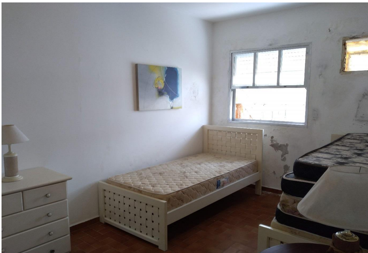
FOTO 13 – Vista parcial interna do imóvel avaliando (dormitório) com o revestimento das paredes deteriorado por infiltrações pela fachada.
