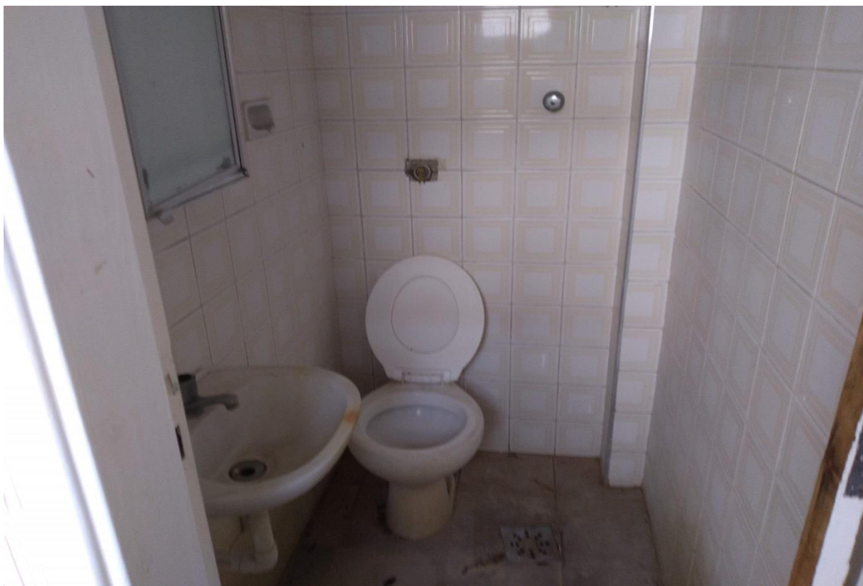
FOTO 11 – Vista parcial interna do imóvel avaliando (banheiro de serviços) com infiltrações pela laje superior.
