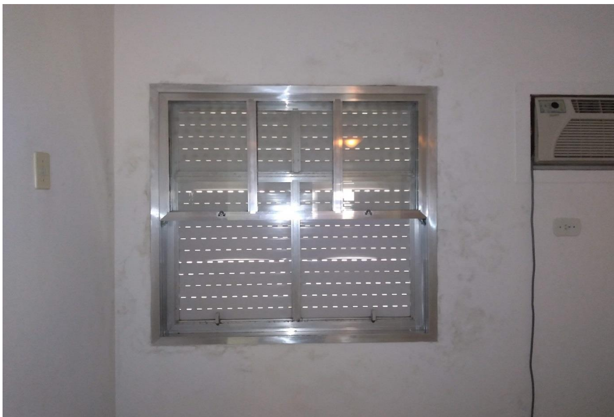
FOTO 20 – Detalhe dos pontos de infiltrações na parede junto a janela.
