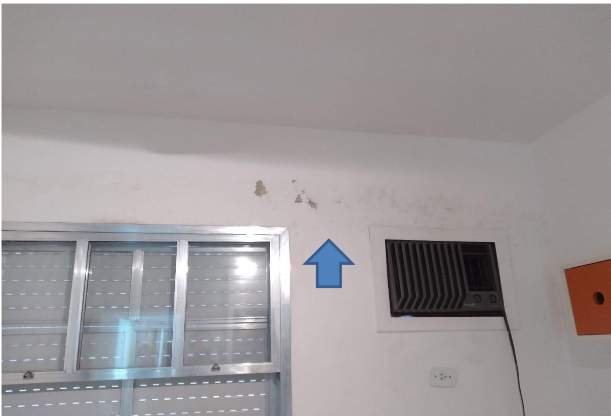
FOTO 16 – Detalhe dos pontos de infiltrações nas paredes e junto ao teto.
