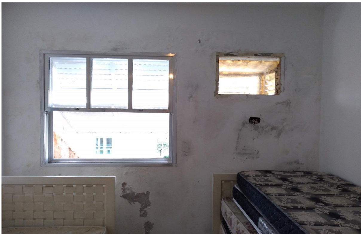
FOTO 14 – Vista parcial interna do dormitório com as paredes deterioradas pelas infiltrações.
